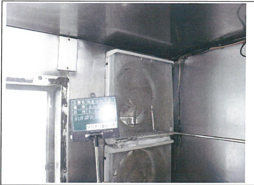
③厨房換気扇 風速測定中
