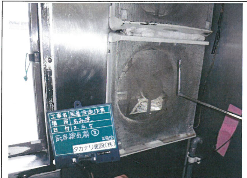
③厨房換気扇 風速測定中
